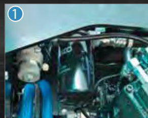
Filtre de pilotage et filtre de retour de fuite des pompes principales
